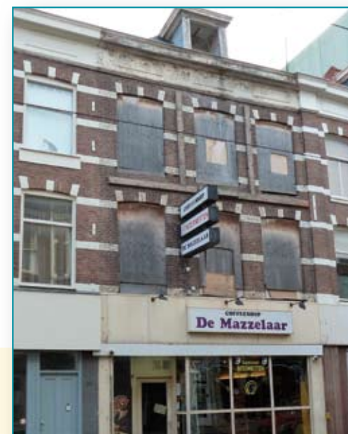
Een brandpand in de Zoutmanstraat
